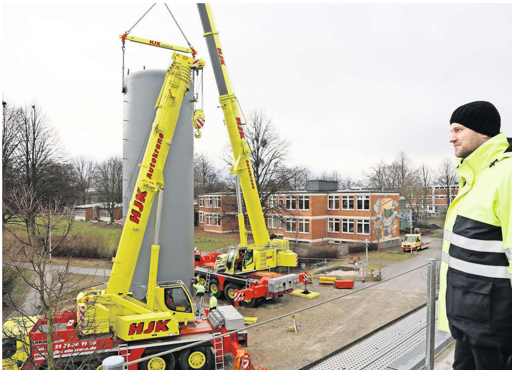
Projektleiter Klaus Blome beobachtet vom Dach der Energiezentrale, wie der Wasserbehälter an seinen neuen Standort gebracht wird.
